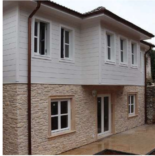
Uygun olmayan kaplama örneği -PVC kaplama + taş görünümlü PVC
