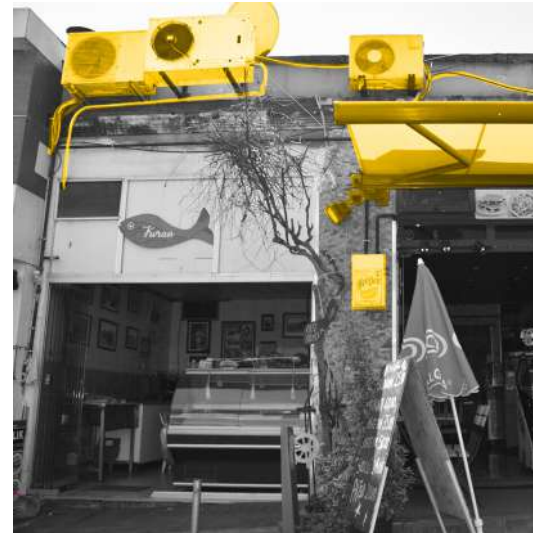
Heybeliada 25 ada 7 parsel / Örnek Uygunsuz cephe eklentileri – kablo-anten-tente
