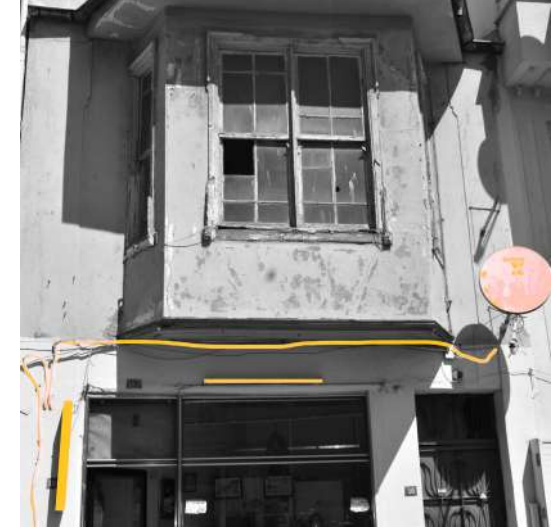
Heybeliada 30 ada 5 parsel / Örnek Uygunsuz cephe eklentileri – kablo-anten
