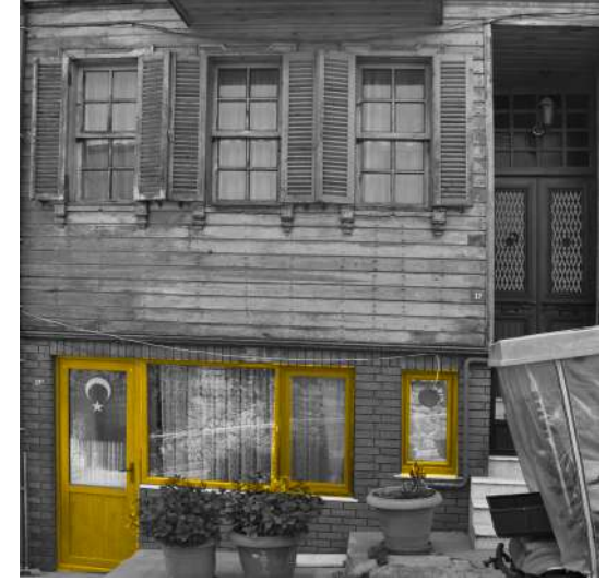
Heybeliada 48 ada 11 parsel / Örnek Uygunsuz Malzeme – form doğrama
